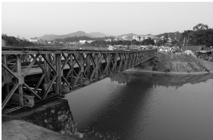
Le pont Bailey sur la Nam Yum à Diên Biên Phu mis en place par les Français est toujours en service
